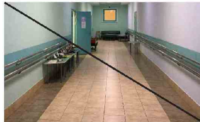
Плохо Керамогранитная плитка с крупными швами
