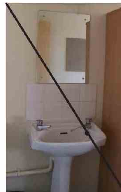
Плохо Раковина с пьедесталом. Фартук из плитки
