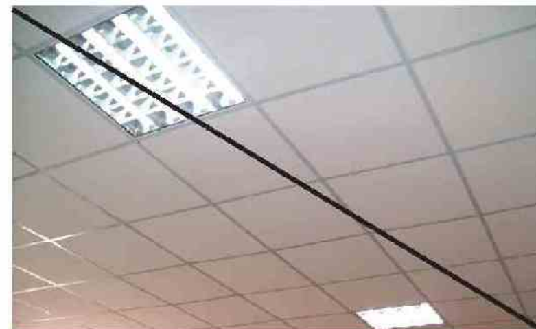
Плохо Открытые направляющие
